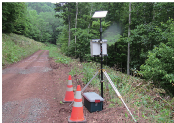
林道工事現場に設置(本体と衛星アンテナを三脚に固定)
