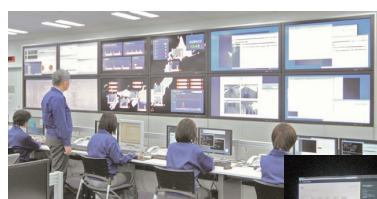
ICT-24SOC オペレーションルーム
